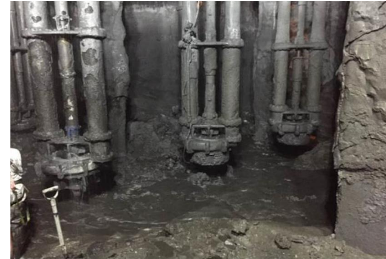
Casa de bombas en Minera Chuquicamata afectada por un proceso de pobre floculación
